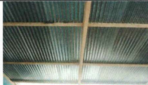
Foto 2: Evidencia la necesidad de cambio de estructura de techo de aula 1, 2, Dirección y corredor.
