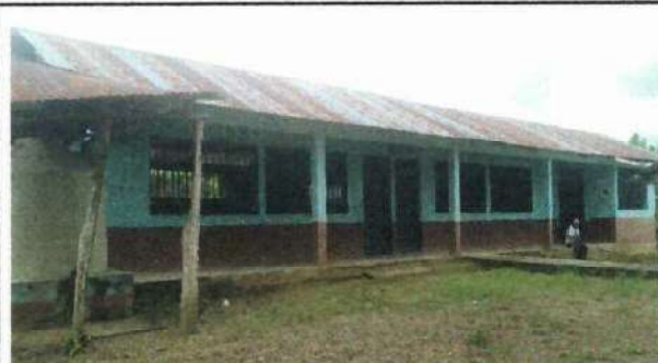
Foto 1: Evidencia la necesidad de cambiar láminas de aula 1, 2, Dirección y corredor.
