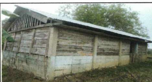
Foto 5: Evidencia la necesidad de reparación y continuación de block de la cocina.
