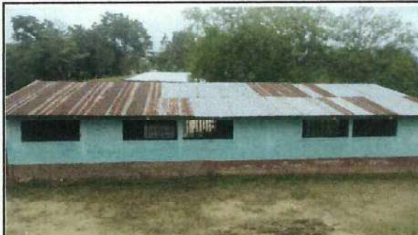
Foto 4: Evidencia la necesidad de pintar interiores y exteriores del establecimiento educativo.
