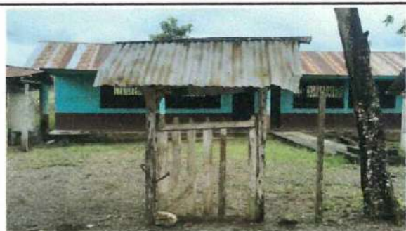
Foto 3: Evidencia que es necesario la sustitución de Portón de ingreso de madera por metal.
